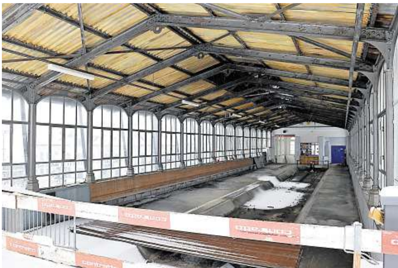
Die Sanierung kann in Angriff genommen werden: Im Hochperron fahren künftig keine Züge mehr ein. Die Industriebaute wird für Billettverkauf, Wartehalle und Shop genutzt werden. Bild Alexandra Kälin
